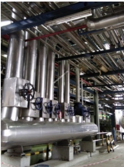
Hình 2.11. Đường ống cấp hơi
