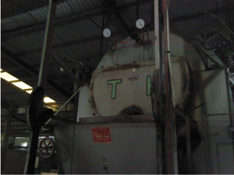
Hình 1. Lò hơi 4 tấn/h đốt than cám
