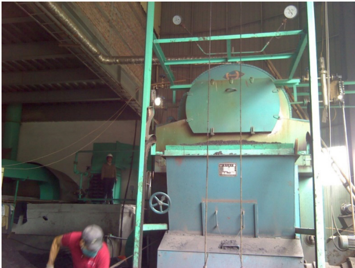
Hình 1. Lò hơi 6 tấn/h đốt than cám
