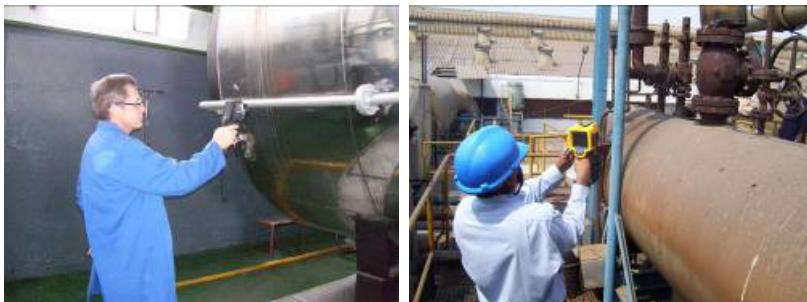
Hình B.8. Sử dụng máy ảnh nhiệt để tiến hành đo đạc đánh giá hệ thống hơi
