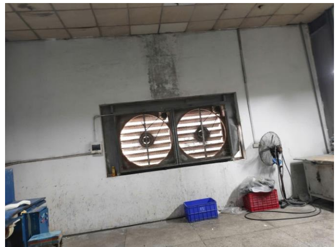
Quạt thông gió và quạt điện khu vực
