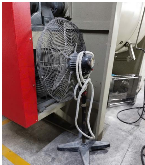
Quạt sử dụng trong nhà xưởng
