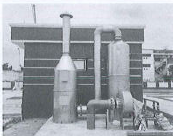
Hình 9 Hình hệ thống xử lý mùi trạm xử lý nước thải
