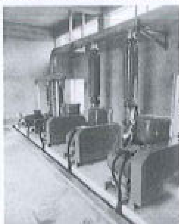
Máy thổi khí trong nhà điều hành
