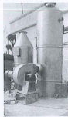
Hệ thống xử lý mùi trạm xử lý nước thải
