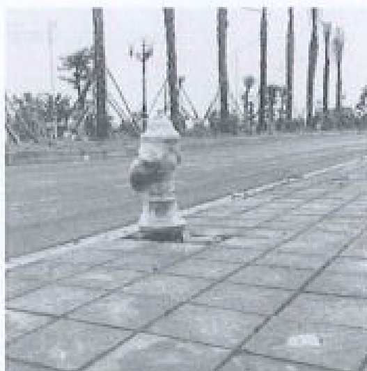
Hình 10. Ảnh chụp một số hệ thống PCCC đã được lắp đặt của dự án
