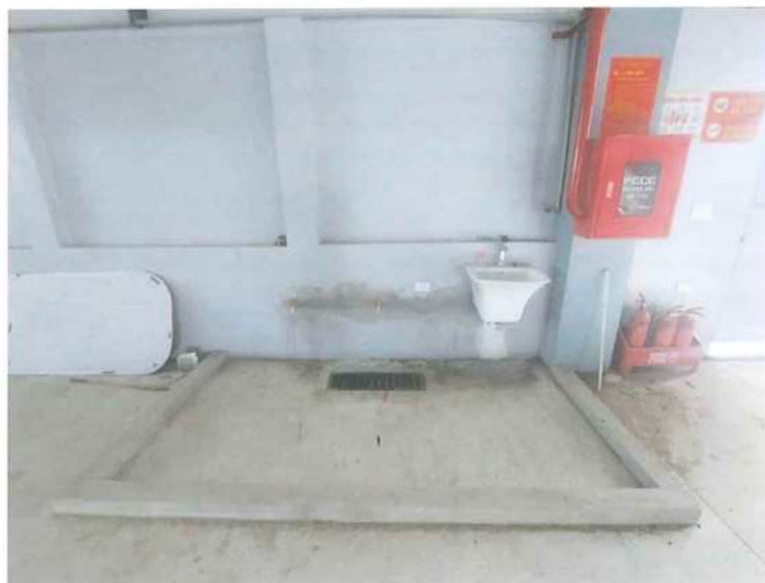
Hình 6. Nơi rửa thiết bị vệ sinh trong quá trình sản xuất
