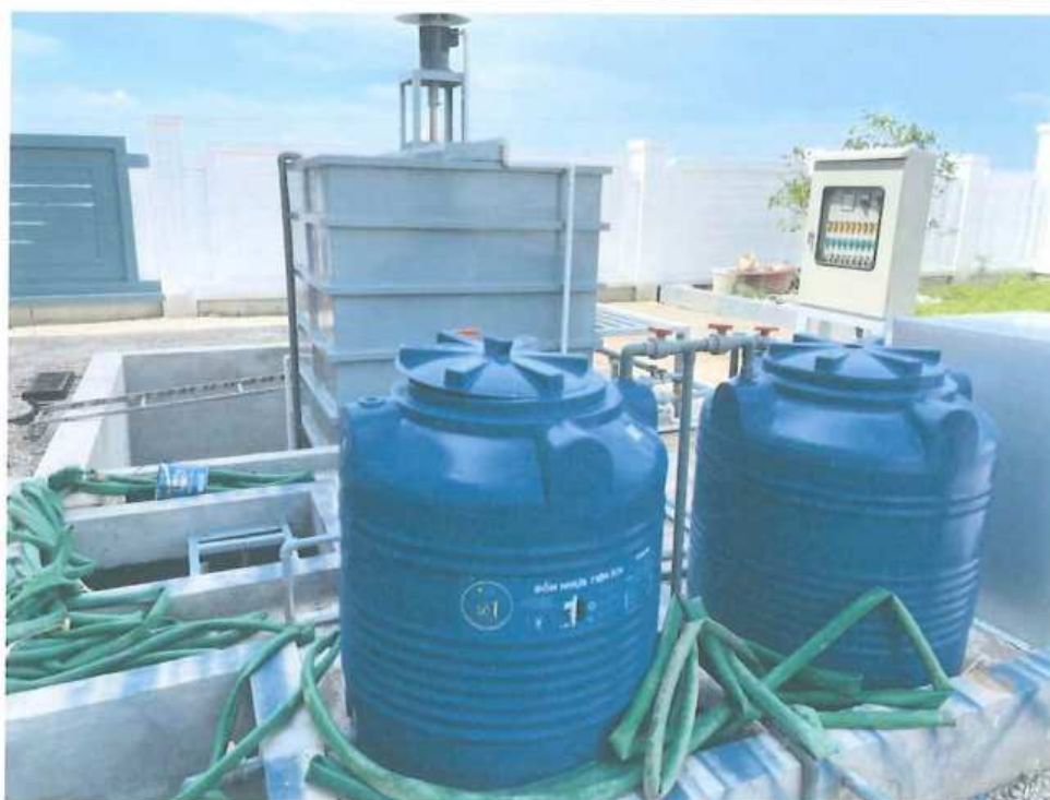
Hình 12. Hình ảnh hệ thống xử lý nước thải tập trung của dự án
