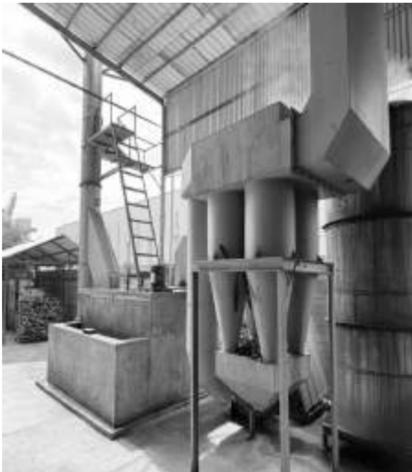
Hình ảnh hệ thống xử lý khí thải của nhà máy:
