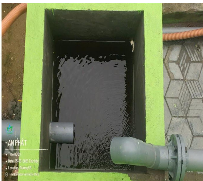
Hố ga đầu ra của hệ thống
