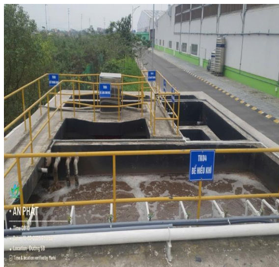
Bể xử lý hiếu khí
