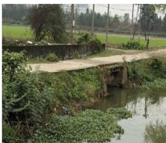
Cầu K1+025 đã được xây dựng lâu đời kết cấu bằng gạch xây, cầu xuống cấp, bề rộng mặt cầu hẹp không đảm bảo giao thông.
