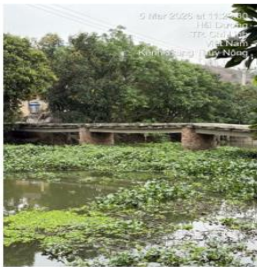
Cầu qua kênh tại K13+198 được xây dựng bằng gạch xây, cầu đã xuống cấp bề rộng mặt cầu hẹp, cần được nâng cấp và cải tạo
