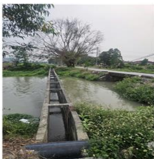
Cầu qua kênh tại K7+040 đã xây dựng lâu đời kết cấu bằng đá xây vữa, cần được nâng cấp cải tạo
