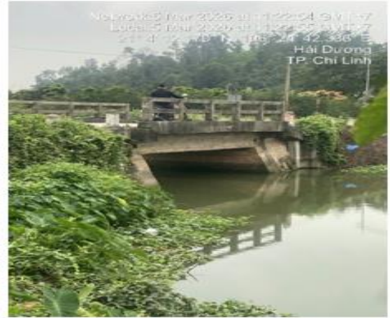
Cầu qua kênh tại K12+558 Cầu được xây dựng đã lâu bằng đá xây, xuống cấp và bề rộng mặt cầu hẹp cần được nâng cấp cải tạo
