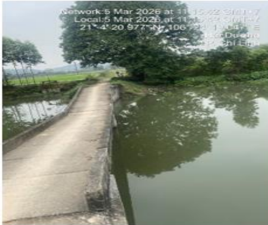
Cầu qua kênh tại K11+802 xây dựng đã lâu, xuống cấp bị hư hỏng, bề rộng mặt cầu hẹp cần được nâng cấp cải tạo
