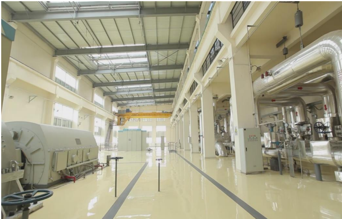
Hình 1.8: Phòng chứa turbin và máy phát điện
