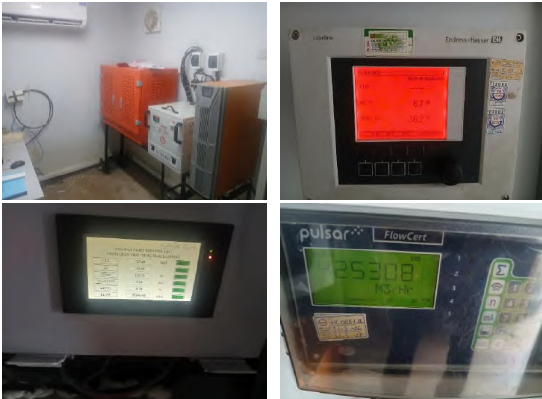
Hình 3.10. Hình ảnh hệ thống quan trắc nước thải tự động, liên tục
