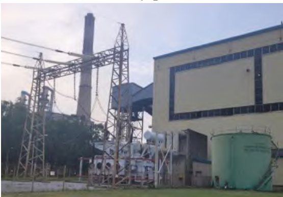
Trạm biến áp
