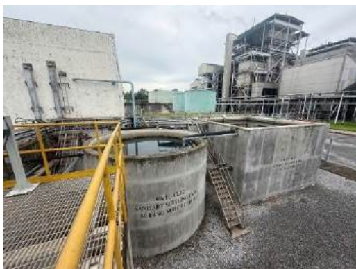
Bể lắng, bể sục khí
