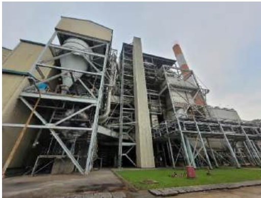
Hệ thống lò hơi
