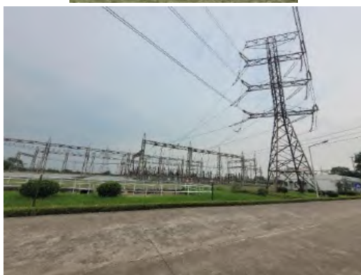
Trạm phân phối điện
