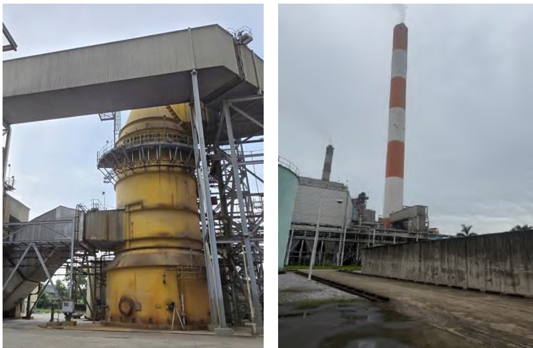
Hình 3.15. Hình ảnh hệ thống xử lý khí thải lò hơi hiện hữu
