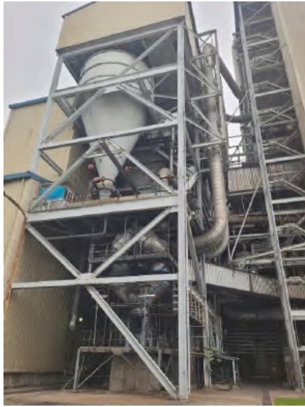
Công đoạn cấp liệu than
