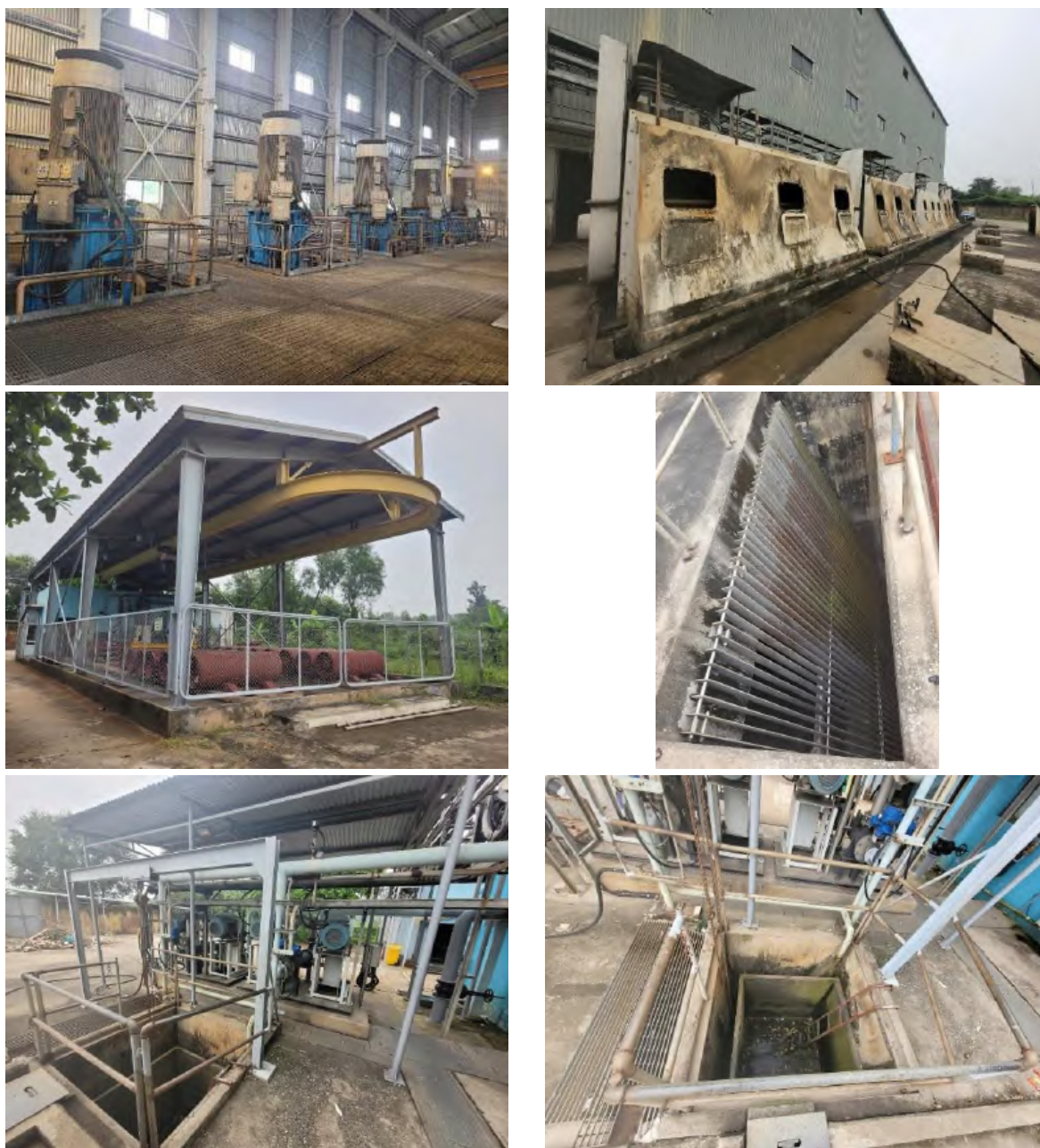
Hình 3.9. Hình ảnh trạm bơm nước tuần hoàn
