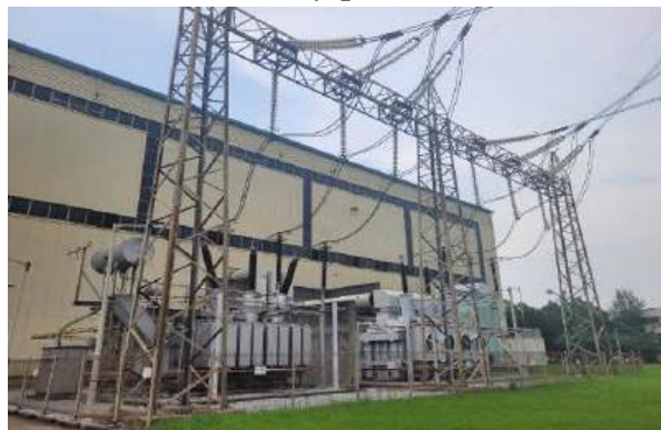
Trạm biến áp
