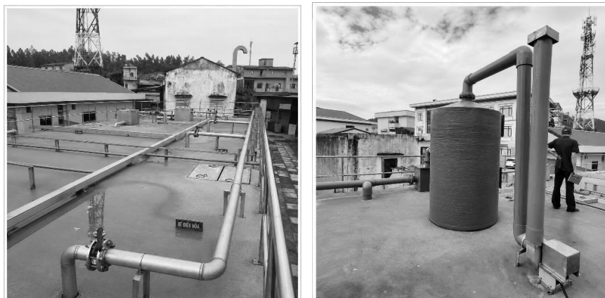
Hình ảnh 1&2 : Hệ thống bể xử lý nước thải 300m 3 /ngày đêm
