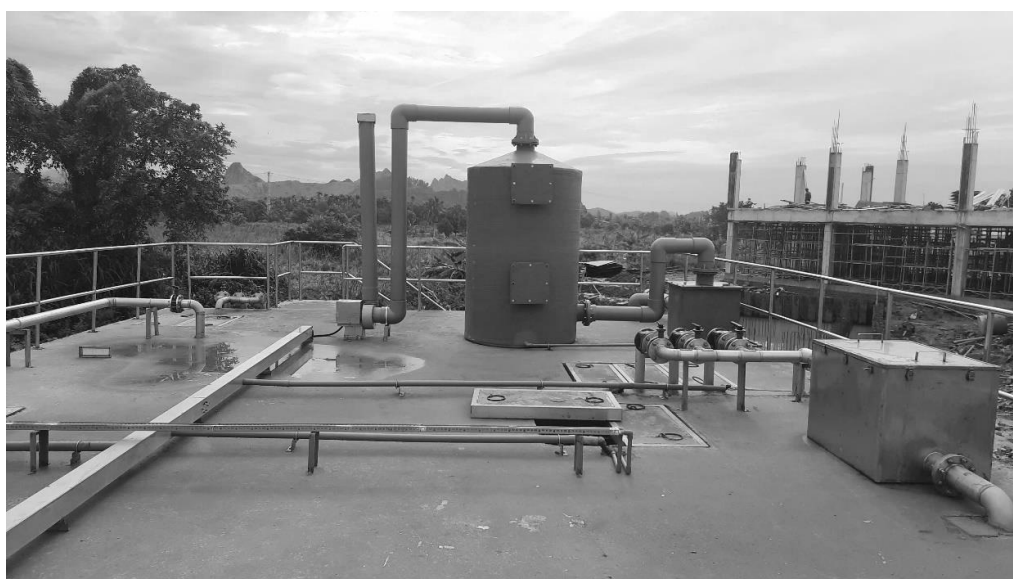
Hình ảnh 3: Hệ thống xử lý mùi, khí thải của HTXLNT 300m 3 /ngày đêm
