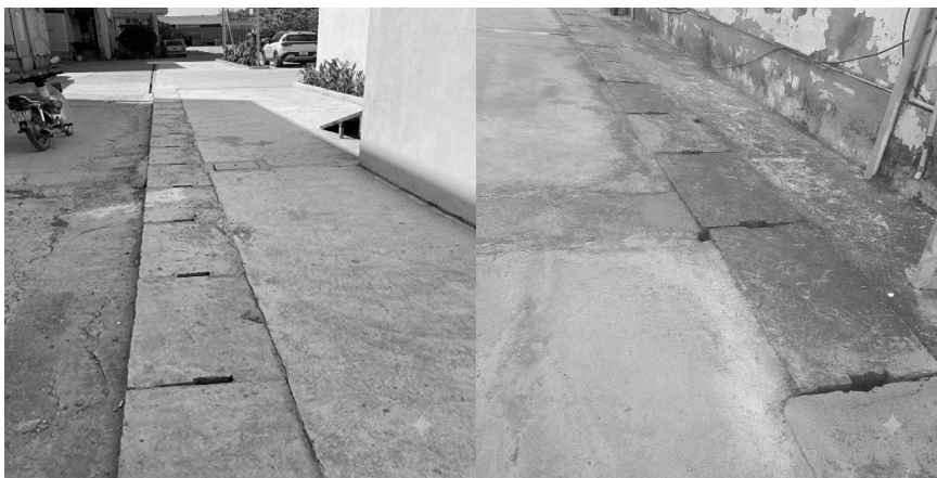
Hình 3.1. Rãnh thu gom nước mái và rãnh thoát nước mưa, nước mặt
