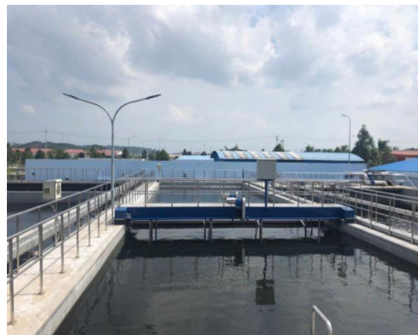
Bể lắng hóa lý 1
