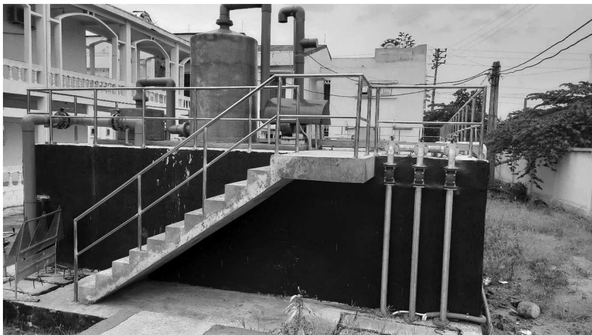
Hình 3.10. Hệ thống xử lý nước thải công suất suất 250m 3 /ngày
