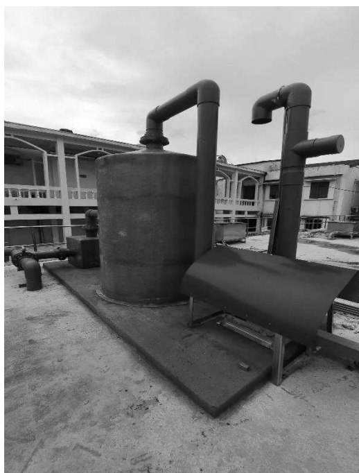
Hình 3.11. Tháp xử lý mùi của trạm xử lý nước thải
