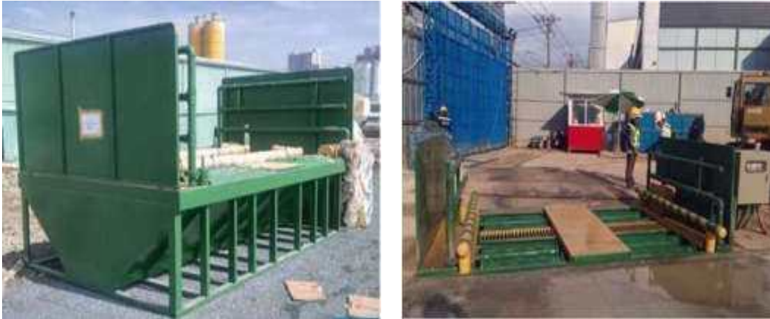
Hình 4. 2. Ảnh minh họa cầu rửa xe tại công trường của dự án
