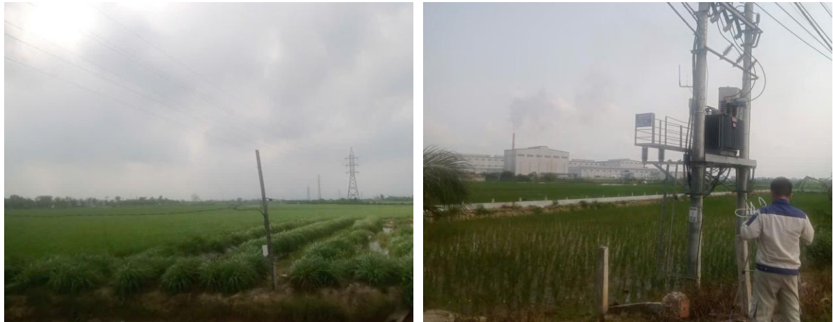
Hình 1.5. Hiện trạng tuyến đường điện 110kV và trạm biến áp 400kVA-35/0,4kV trong khu vực thực hiện dự án
