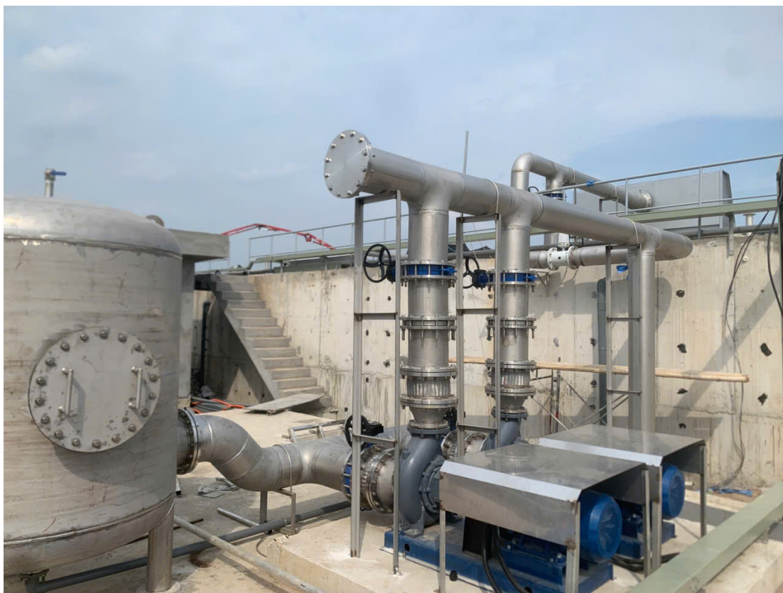
Hình 3.8. Một số hình ảnh trạm xử lý hệ thống xử lý nước thải tập trung của cụm công nghiệp
