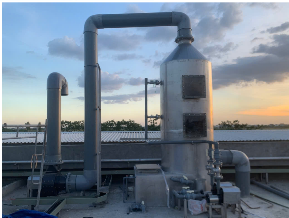
Hình 3.9. Tháp xử lý mùi
