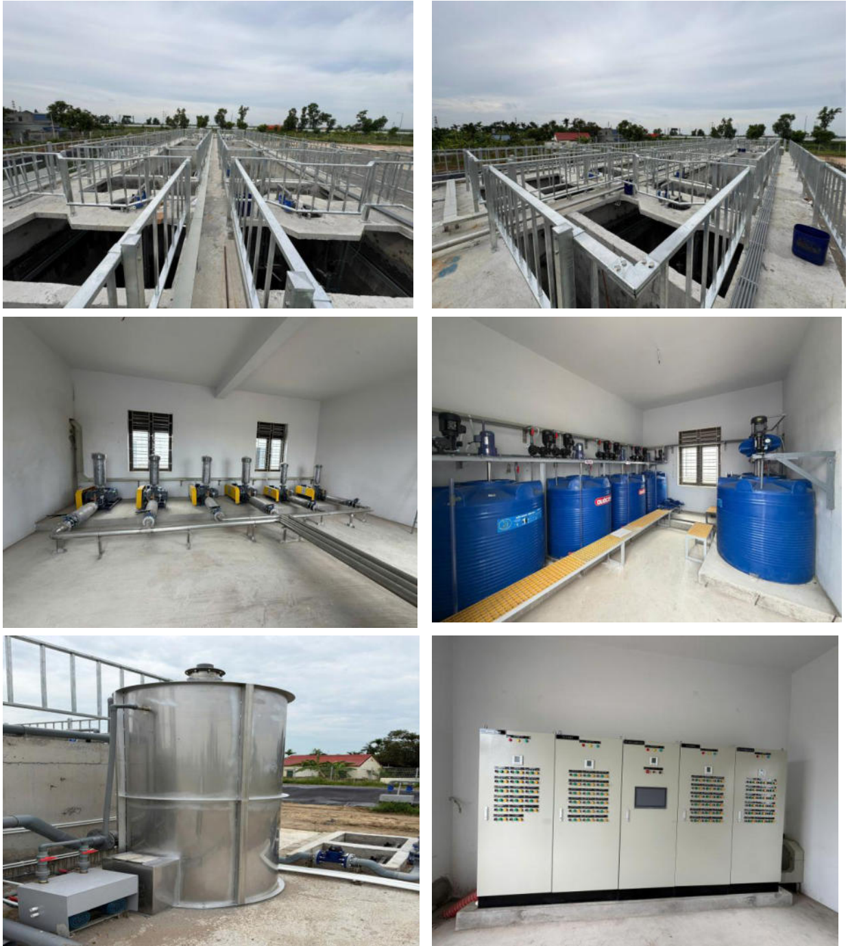
Hình 3.7. Hình ảnh trạm xử lý nước thải của dự án
