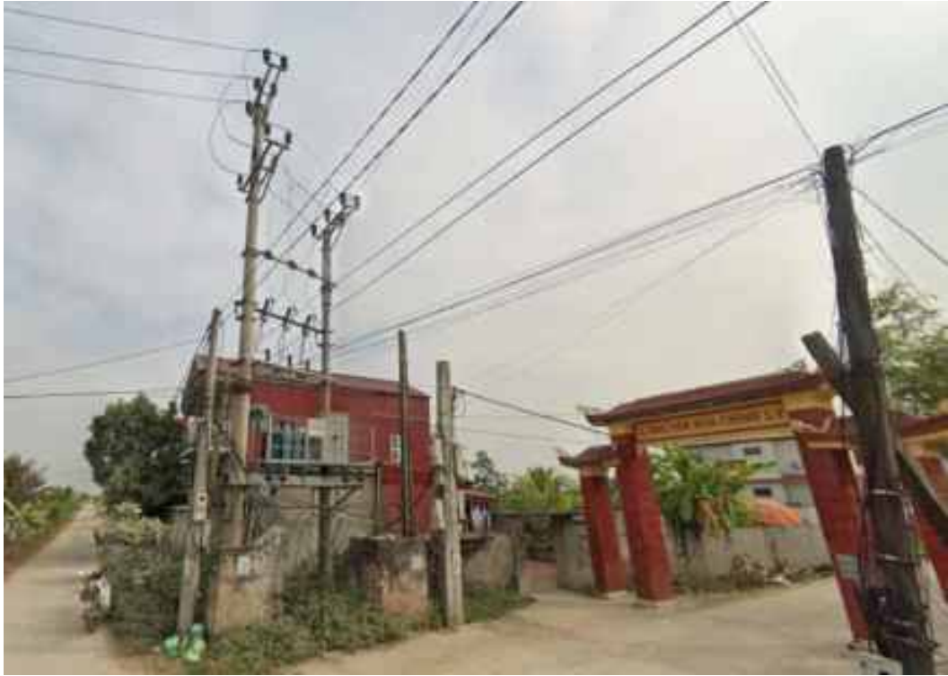
Hình 1. 8. Trạm biến áp Chính Lý ngoài ranh giới dự án
