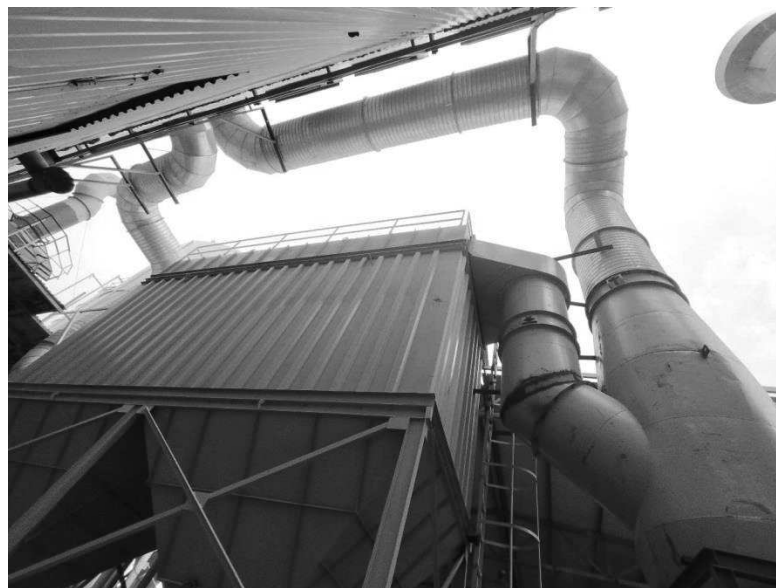
Hình 3.22. Thiết bị lọc bụi túi vải của hệ thống xử lý của dây chuyền 3 và 4
