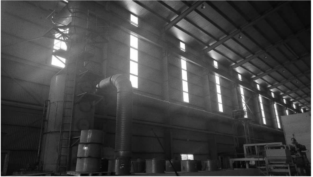
Hình 3.17. Hệ thống xử lý bụi, khí thải của công đoạn ép tấm dây chuyền 2 2.3. Các công trình xử lý khí thải của quá trình cân định lượng, phối trộn, rải liệu của dây chuyền 3 và 4
