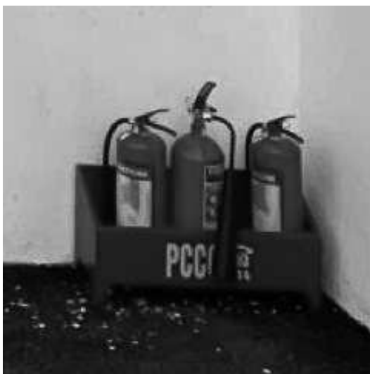
Hình 3.30. Hệ thống phòng cháy chữa cháy của cơ sở
