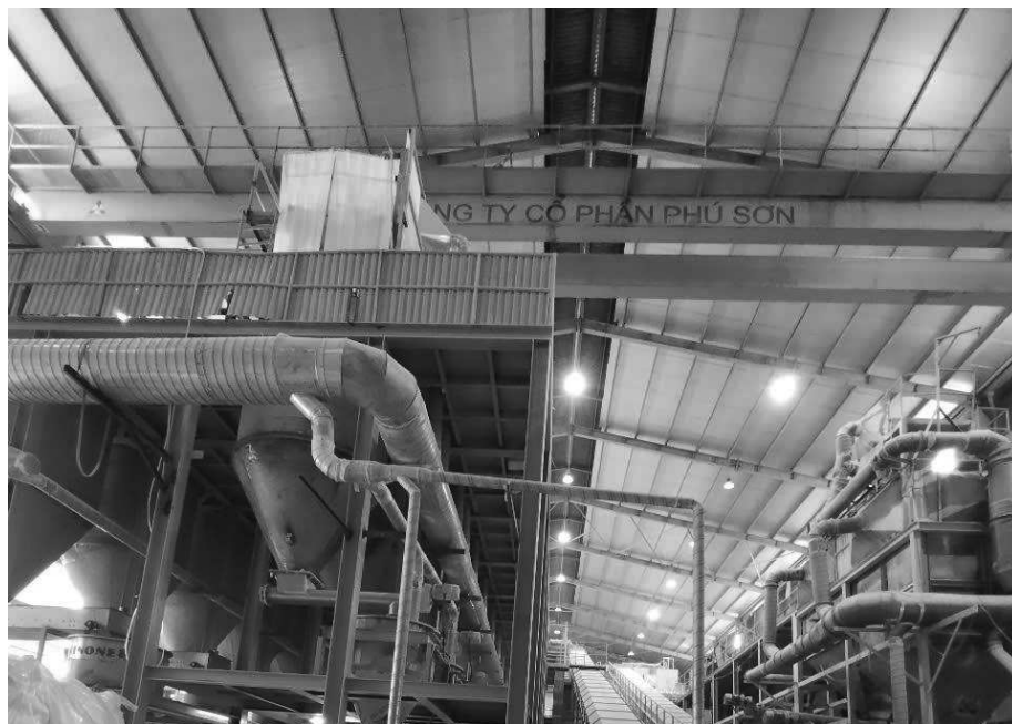
Hình 3.18. Hệ thống lọc bụi khu vực trộn và cấp liệu dây chuyền 3
