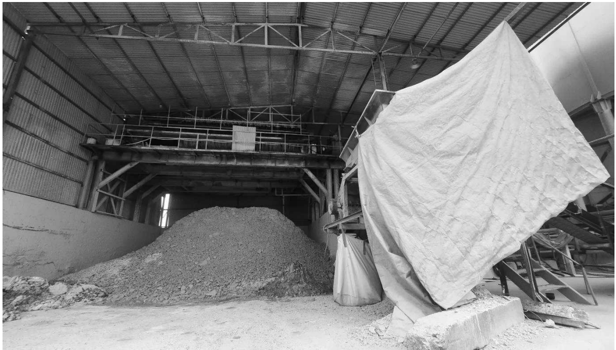
Hình 3.11. Máy ép bùn của hệ thống xử lý nước thải sản xuất
