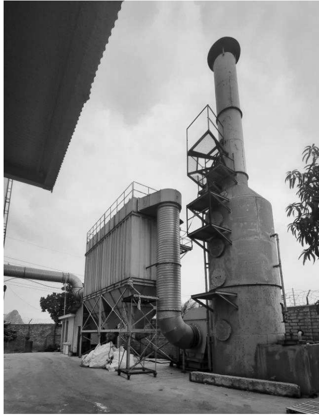
Hình 3.14. Hệ thống lọc bụi và xử lý khí thải khu vực cân định lượng, phối trộn, rải liệu dây chuyền 2
