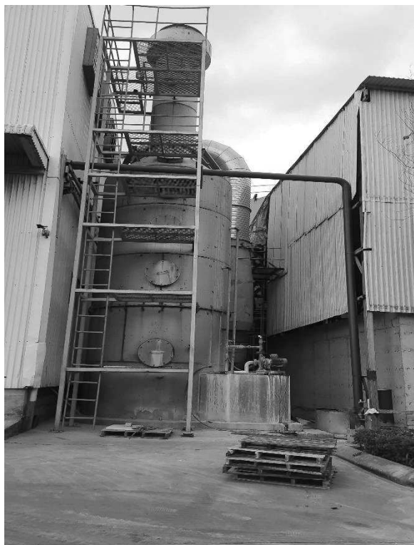
Hình 3.23. Tháp hấp thụ kết hợp hấp phụ của hệ thống xử lý bụi và khí thải dây chuyền 3+4
