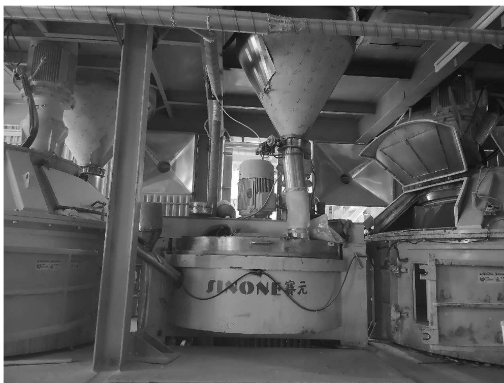
Hình 3.19. Hệ thống lọc bụi khu vực trộn và cấp liệu dây chuyền 4
