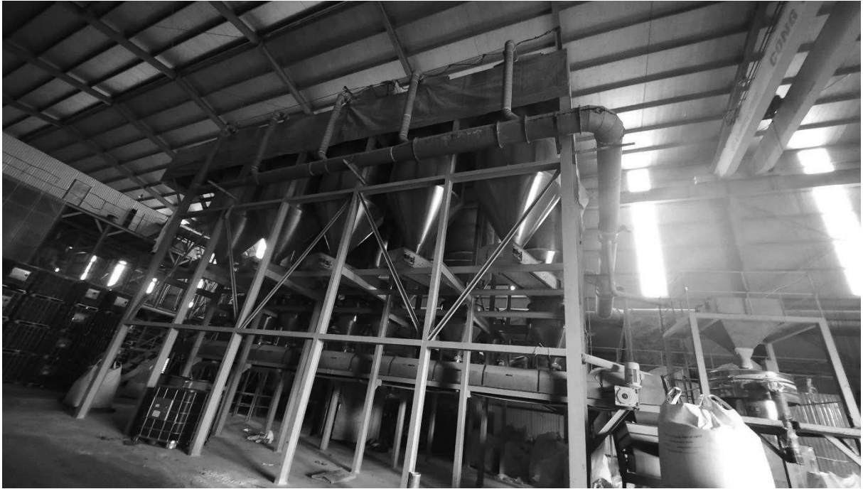
Hình 1.6. Khu vực cấp liệu, rải liệu dây chuyền 2
