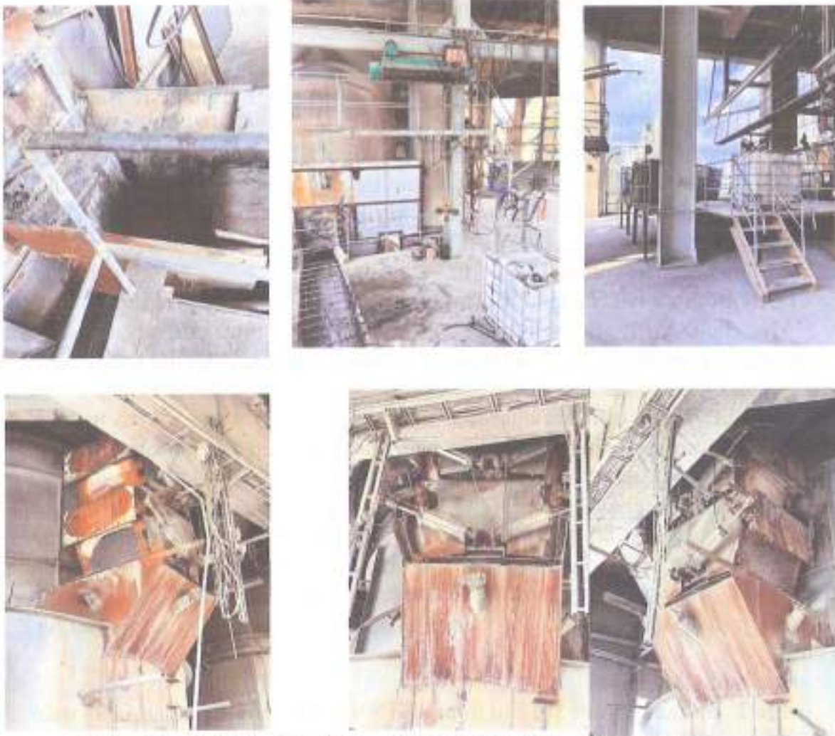
Hình 4.2. Hình ảnh công trình xử lý chất thải tại Canciner HT3
