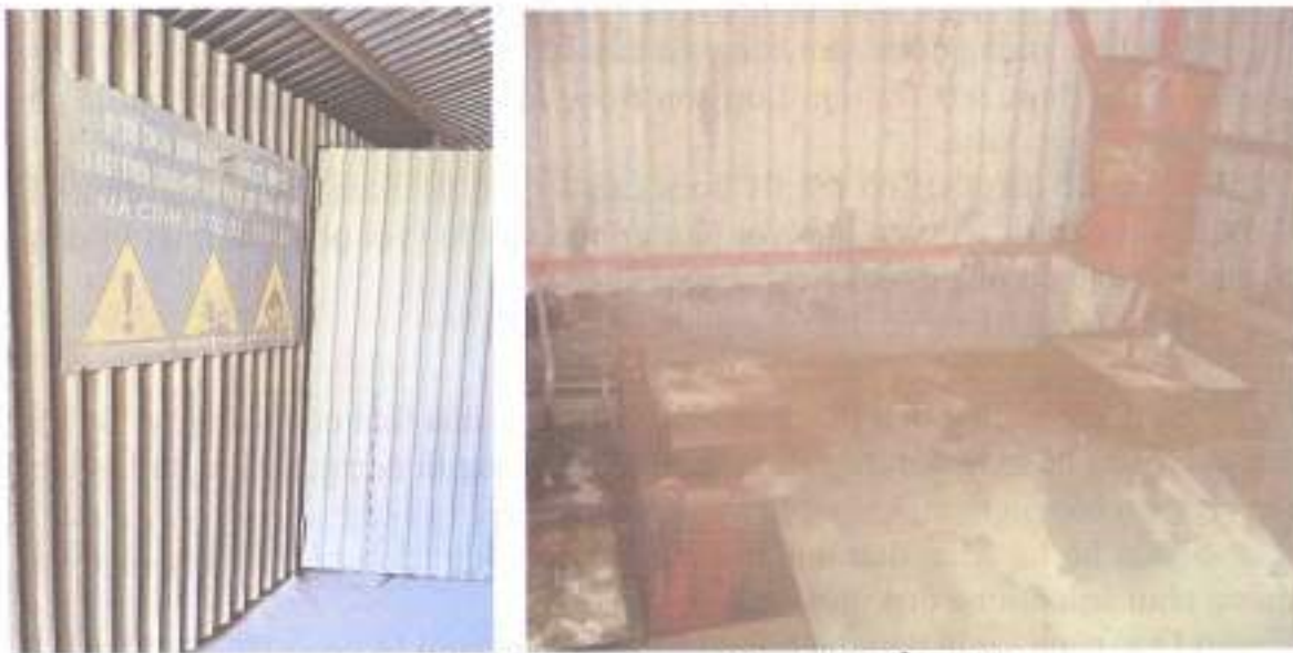
Hình 4.1. Hình ảnh công trình xử lý dầu thải
