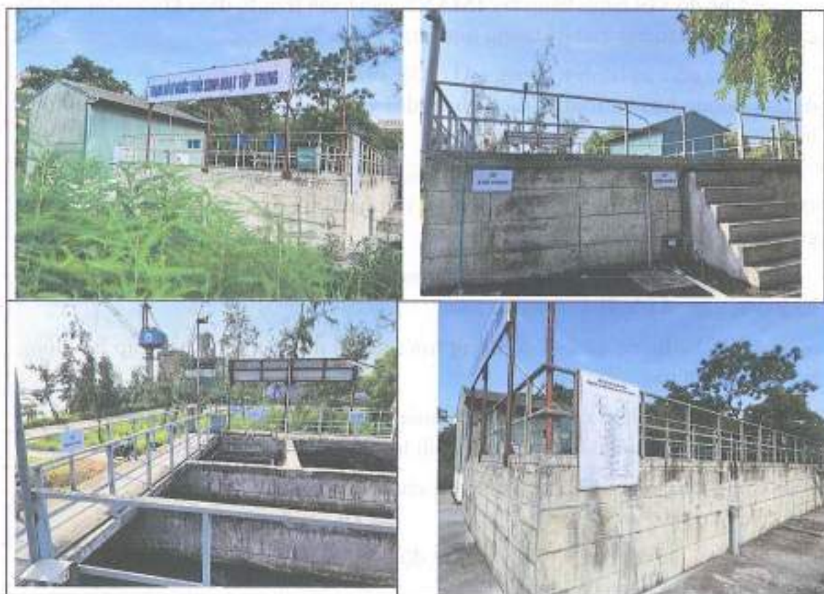
Hình 3.7. Một số hình ảnh hệ thống xử lý nước thải tập trung của Nhà máy
