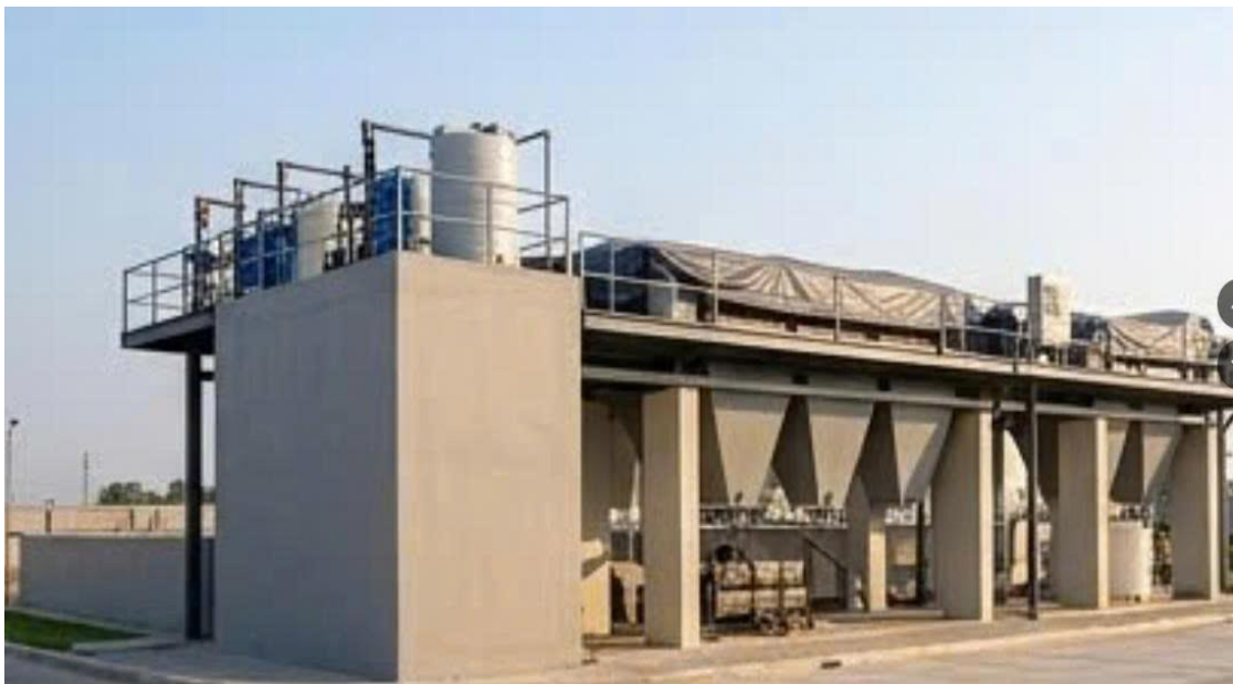
Hình 3.6. Một số hình ảnh trạm xử lý hệ thống xử lý nước thải tập trung của cụm công nghiệp
