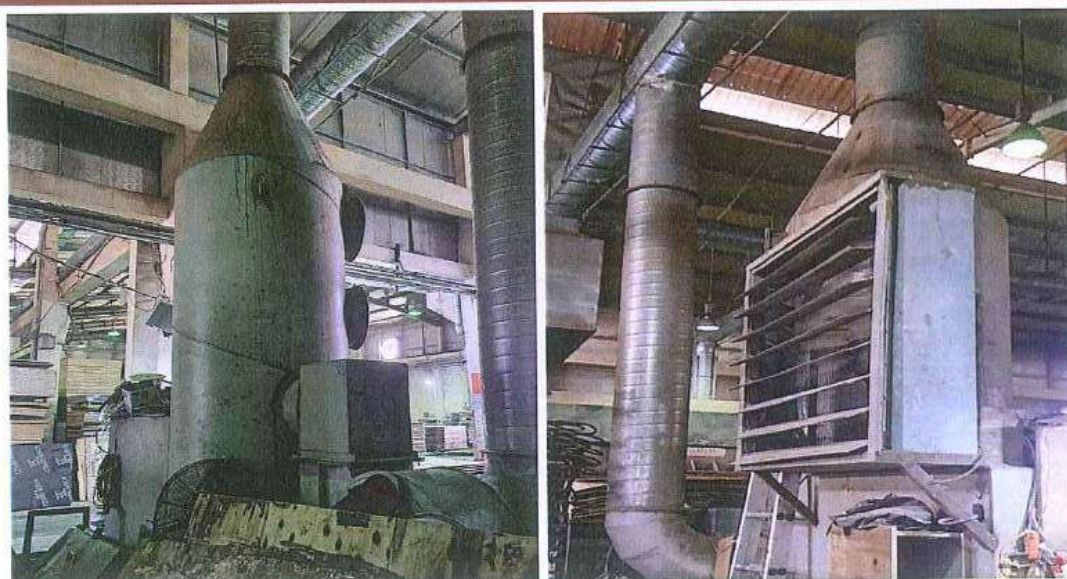
Hình 3.9. Hệ thống xử lý khí thải ở khu vực khuấy keo (tô keo)
