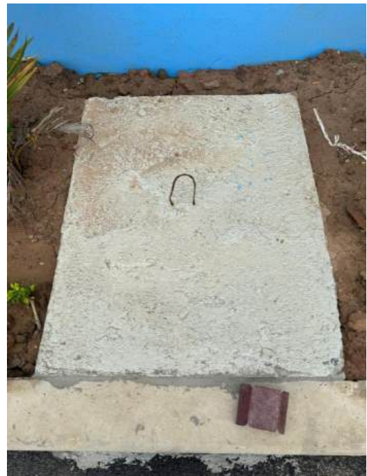
Nắp hố ga nước mưa
