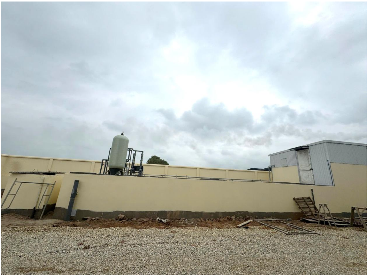
Hình 3.7. Trạm xử lý nước thải công suất 100 m 3 /ngày đêm của nhà máy
