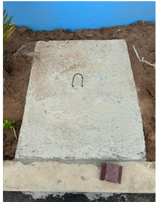
Nắp hố ga nước mưa
