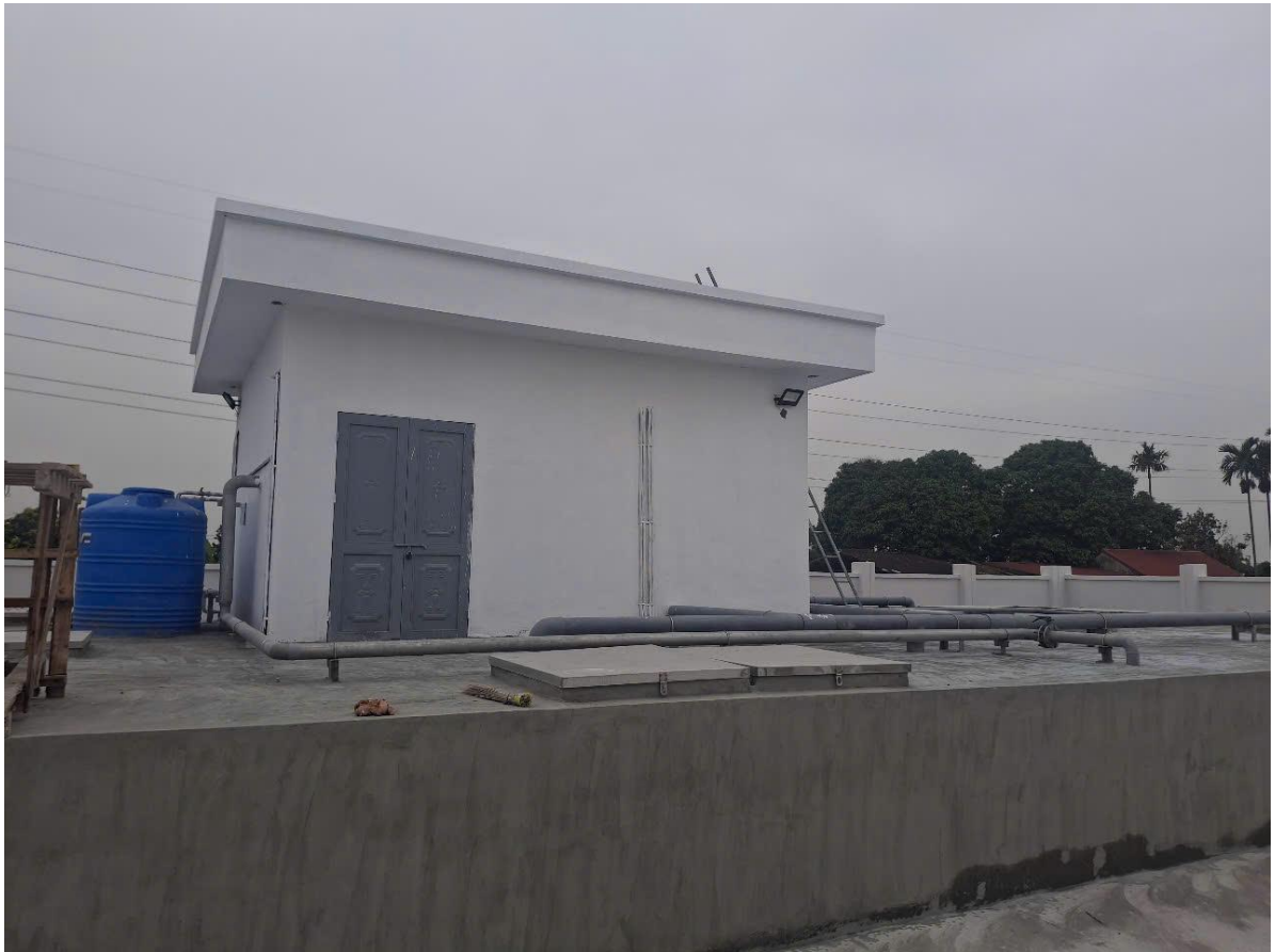
Hình 9 Hình ảnh hệ thống xử lý nước thải của dự án
