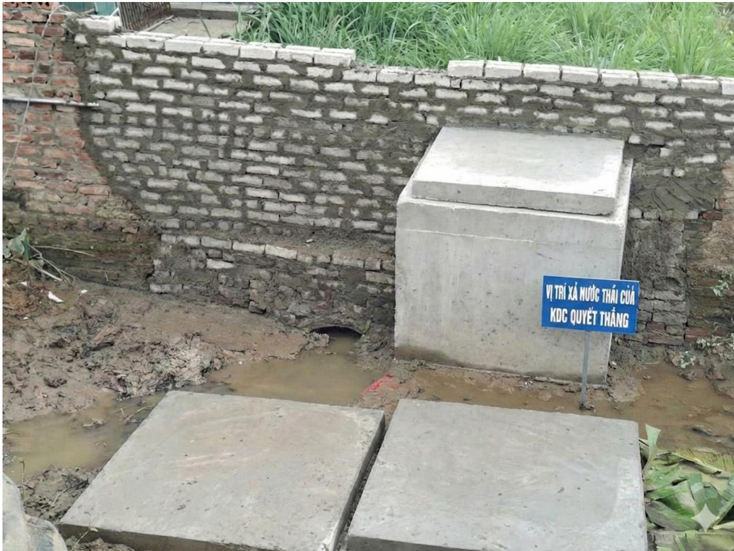
Hình 6. Hình ảnh vị trí thoát nước thải của dự án
