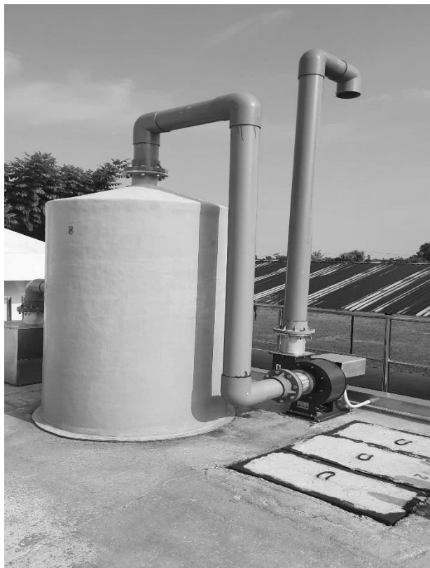
Hình 3.6. Tháp xử lý mùi của trạm xử lý nước thải
