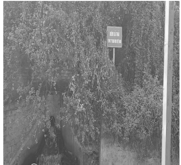
Đầm xả nước thải
