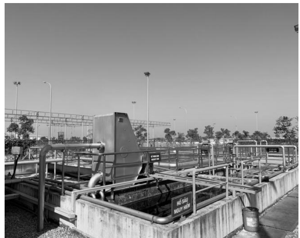
Hệ thống lọc màng MBR
