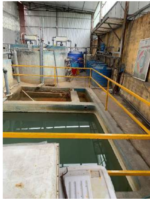
Hệ thống xử lý nước thải sản xuất
