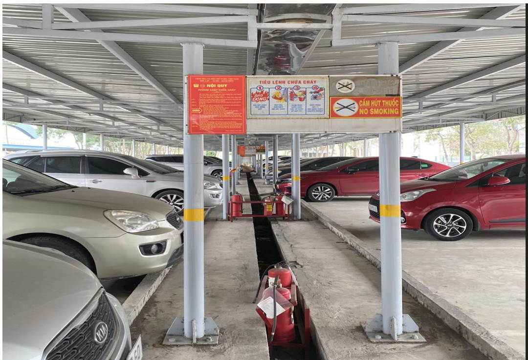
Hình 3.17. Thiết bị phòng cháy chữa cháy của Cơ sở
