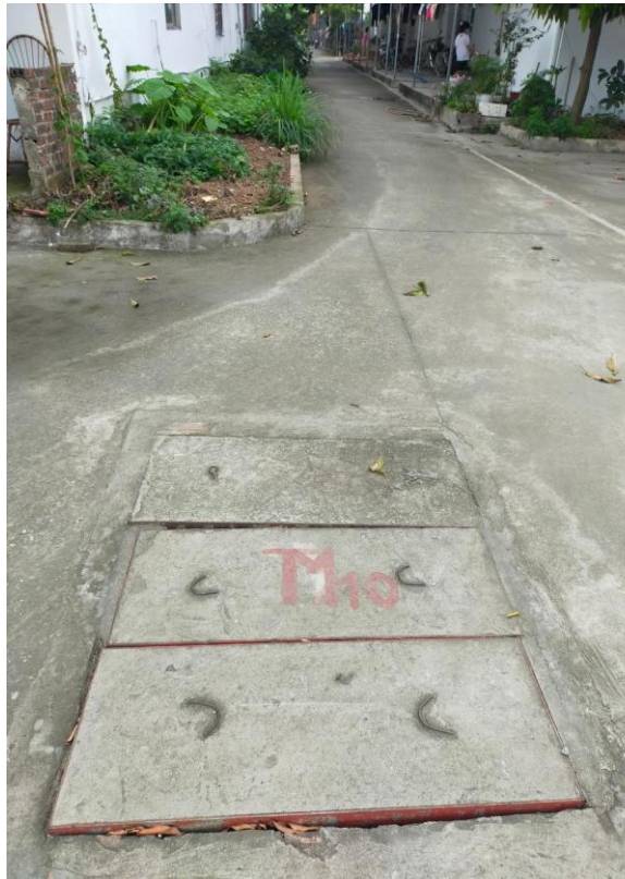
Hố ga thu nước mưa
