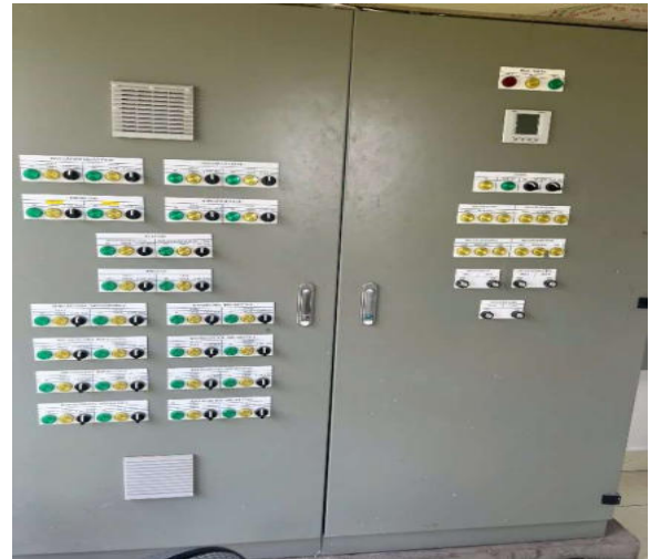
Tủ điều khiển
