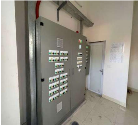
Tủ điều khiển
