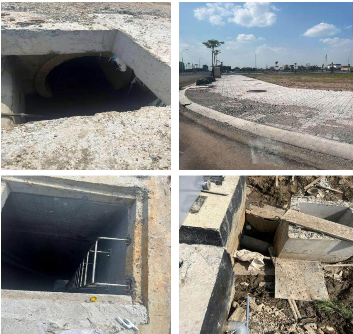
Hình 3. 2. Hệ thống thoát nước mưa dự án đã xây dựng
