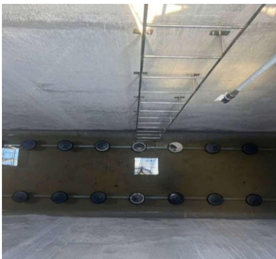
Hệ thống cấp khí
