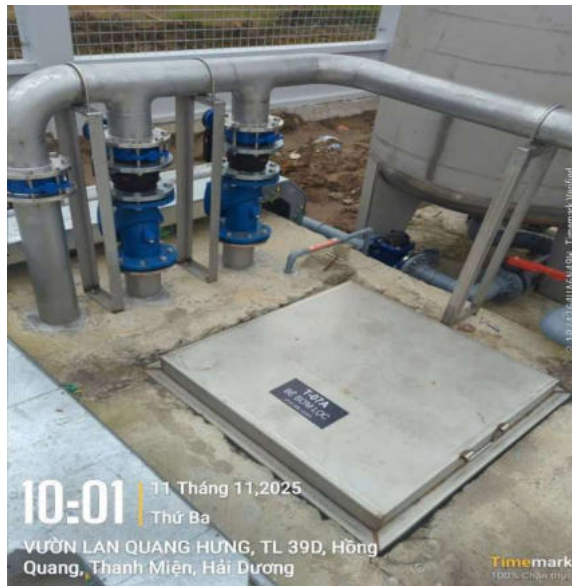
Bể bơm lọc
