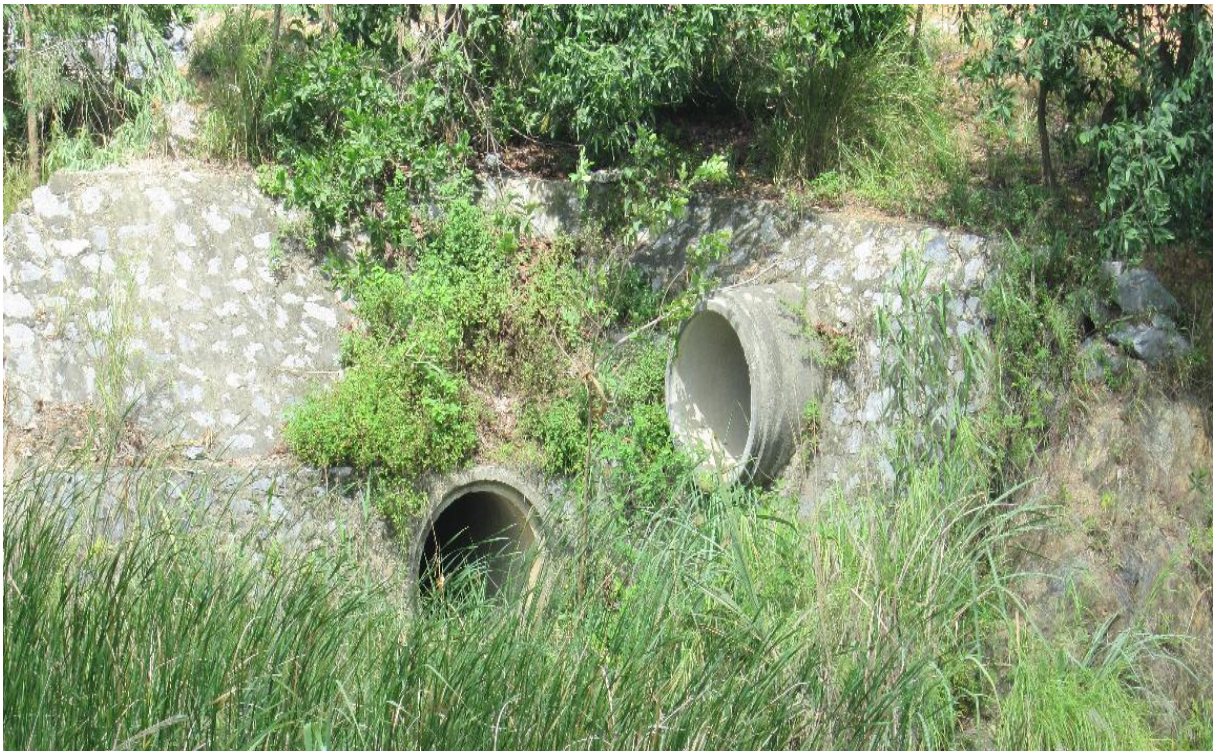
Cống thoát nước tại hồ lắng số 01 và hồ lắng số 3
