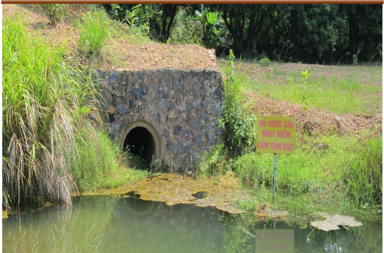
Cống thoát nước tại hồ lắng số 2
