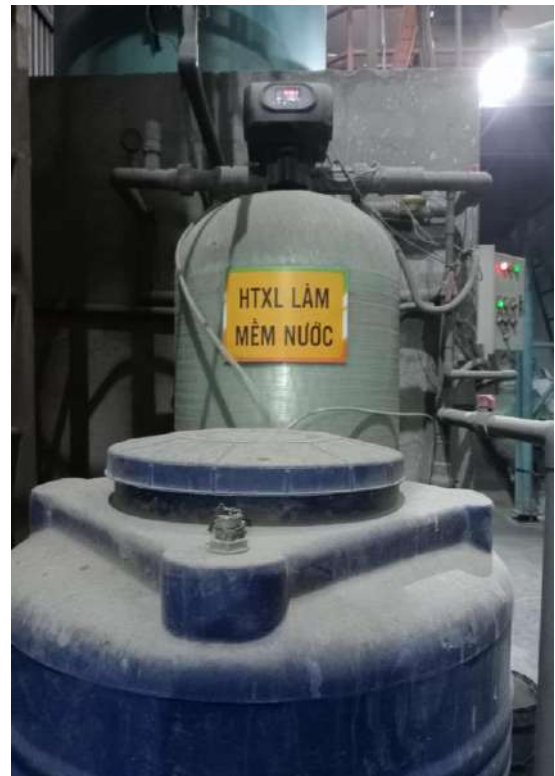
Hệ thống làm mềm nước
