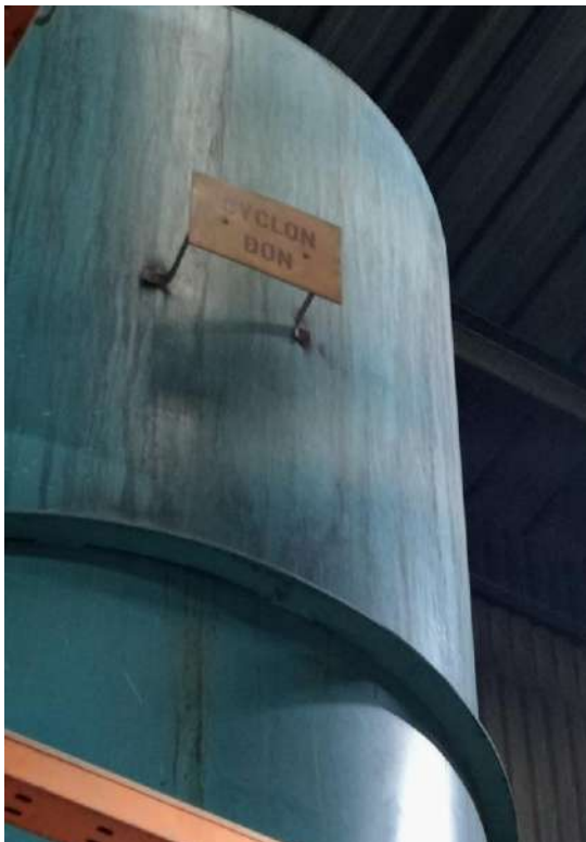
Cyclon dập bụi lò hơi
